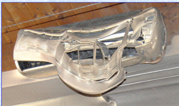
Incendio da guasti delle apparecchiature
