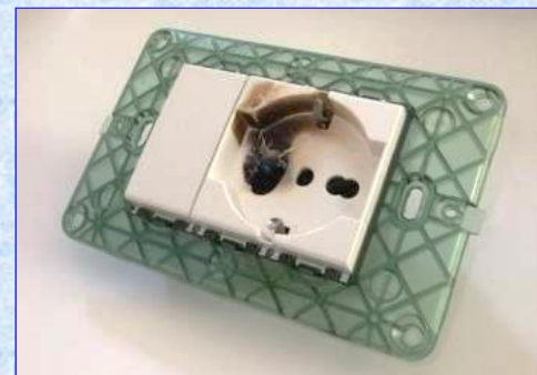
Incendio da sovraccarichi
